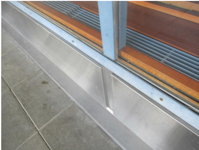
Kuva 3.4.4: Metallikarmisten ikkunoiden kunnostuksiin on perusteltua varautua niin ikään tarkastelujakson alkupuolella.
