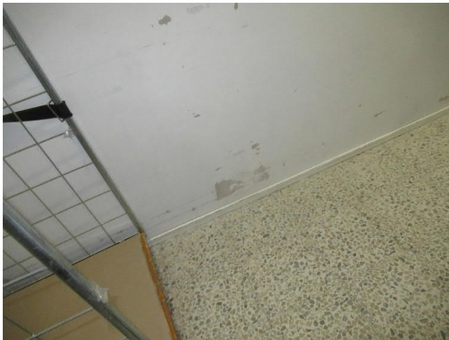
Kuva 3.6.2: B1-sisäänkäynnin käytävällä paikallista seinäpintojen kulumaa.
